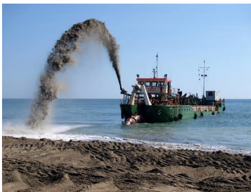
Refluento tramite "rainbow": Circa 20 milioni di metri cubi di sabbia sono stati dragati fino ad oggi in Italia sui fondali marini per il ripascimento dei litorali. (foto di E.Pranzini)
